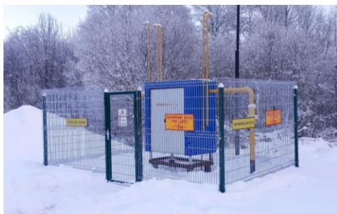
Распределительный газопровод в микрорайоне «Северный» г. Бабаево
