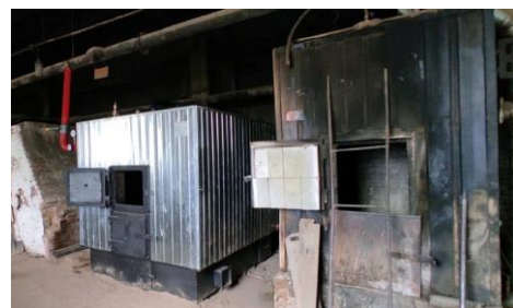
Новый котел KVp-0.8
